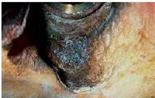
Figure 1 : Photographie de l'endommagement découvert
